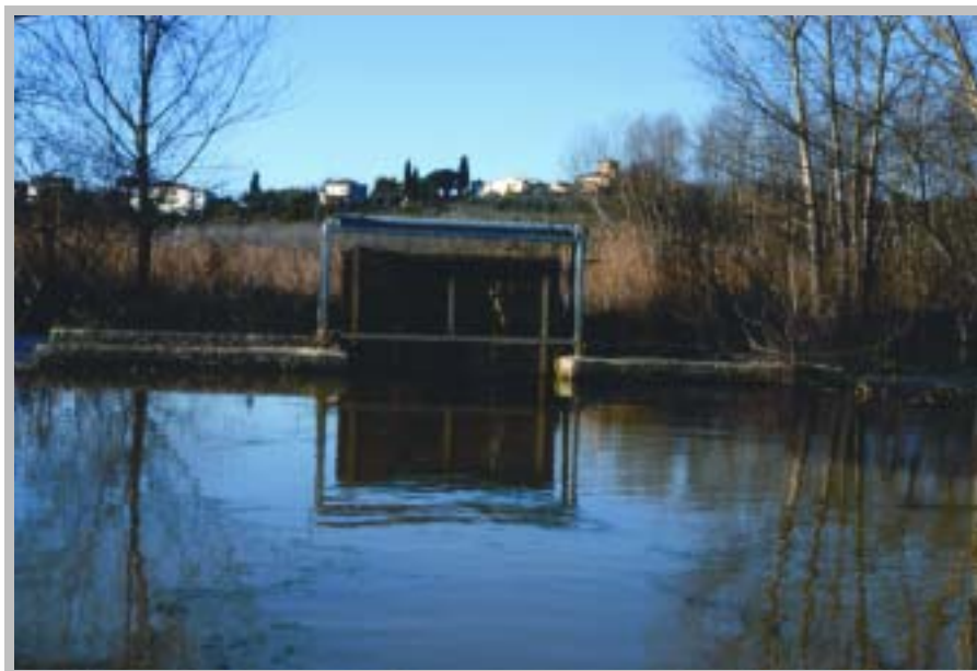
Fig. 6 - I manufatti principali e secondari per la gestione delle acque permettono la regolazione dei flussi idrici nei crateri palustri. La loro manutenzione funzionale consente, sia la corretta gestione idraulica e quindi la riduzione dei rischi connessi, sia la possibilità di programmare opportuni cicli di immissione o di scarico delle acque nei diversi comparti della zona umida al fine di garantire le migliori condizioni vitali (foto F. Sorbetti Guerri).
