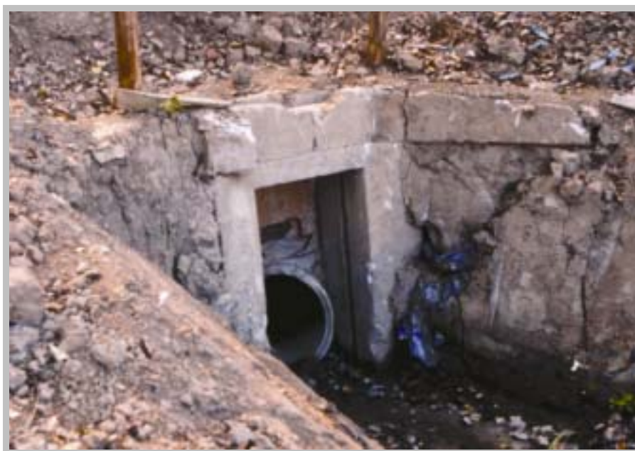
Fig. 14 - I manufatti per la regolazione delle acque, presenti nelle zone umide, richiedono spesso interventi di adeguamento e di manutenzione per ripristinare le loro funzioni. Tali interventi, che rappresentano esigenze irrinunciabili per il buon governo della zona umida e nonostante siano, di norma, di modesto impegno, spesso vengono trascurati portando a inevitabile riduzione di valore di comprensori anche molto ampi (foto E. Bresci).
